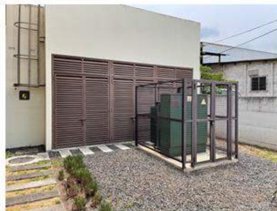
VISTA DE EQUIPOS
