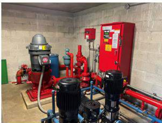
VISTA DE EQUIPOS
