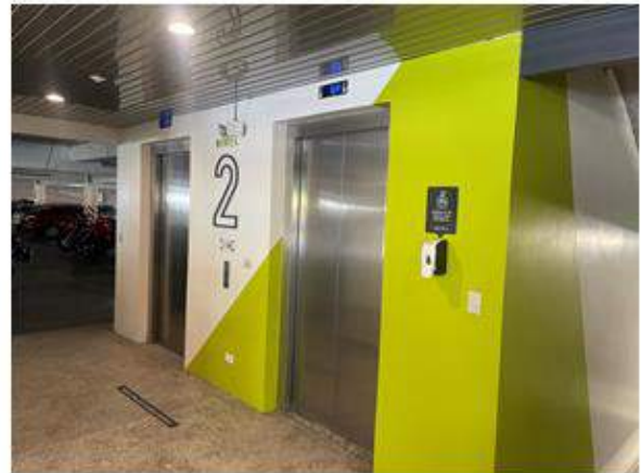
VISTA DE ASCENSOR
