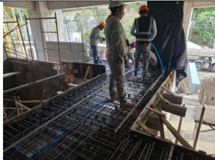
Fotografía 9. Canalizaciones eléctricas en losa
