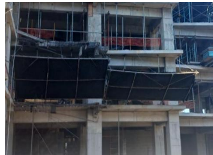
Fotografía 2. Mallas de protección contra caídas
