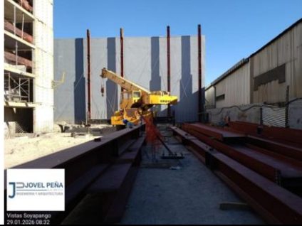
Fotografía 9. Inicio de actividades de montaje en eje 1 – ejes A, B, C y D de edificio de Parqueos.
