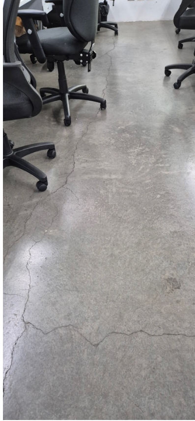
Agrietamiento Superficial Nivel 5
