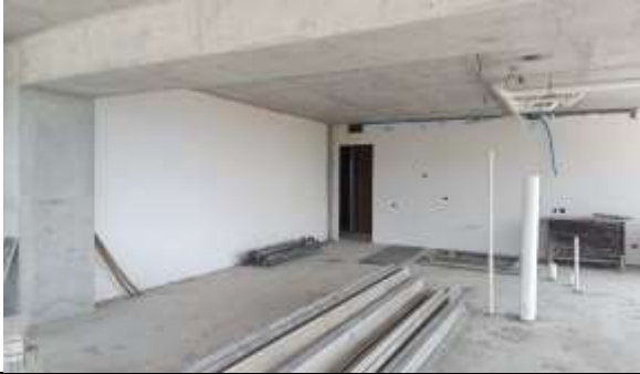
Fotografía 5. Instalaciones hidráulicas, SCI, electrónicos y eléctrico en áreas de pasillos N9
