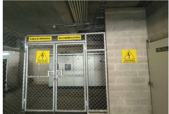
AREA DE ESTACION ELECTRICA EN P1
