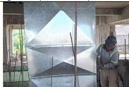
Fotografía 10. Ducto de presurización nivel 14
