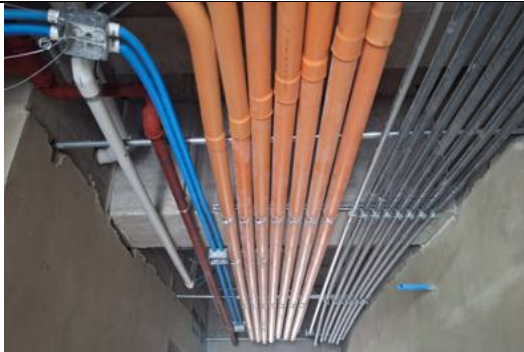
Fotografía 11. Instalaciones eléctricas en pasillo de nivel 4
