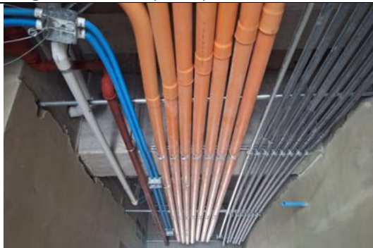
Fotografía 11. Instalaciones eléctricas en pasillo de nivel 4
