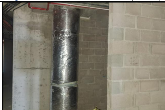
Fotografía 8. Ducto para basura, nivel 4
