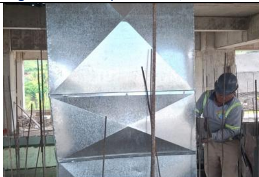
Fotografía 10. Ducto de presurización nivel 14
