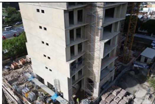
Fotografía 8. Repello en fachada poniente
