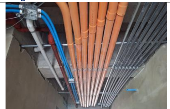
Fotografía 11. Instalaciones eléctricas en pasillo de nivel 4
